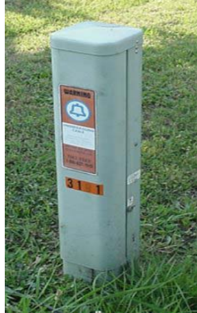
En slik telefonkoblingsboks (plintboks) som står ved veien.
